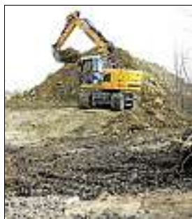
Das Zwischenlager an der Bahnhofstraße wächst stetig. Foto: H. Schumann
